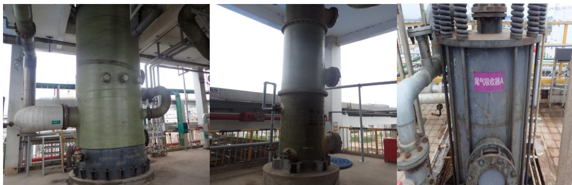
氯尾气吸收塔
